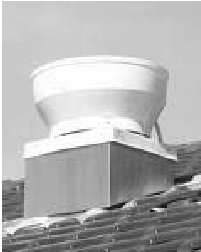
ภาพที่ 1.8 พัดลมที่ดูดอากาศที่ติดตั้งไว้บนหลังคา
