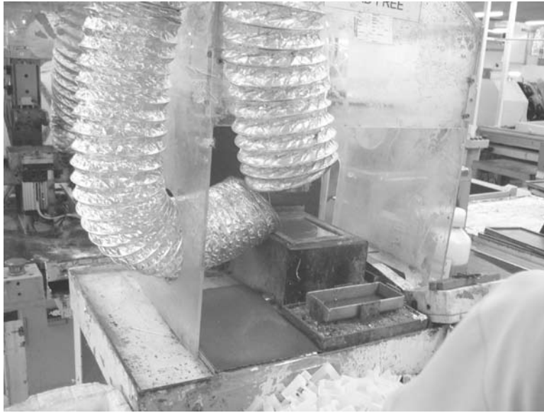
ภาพที่ 1.6 ท่อระบายอากาศเฉพาะที่
